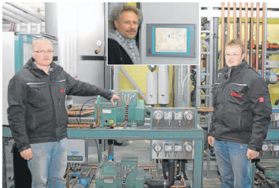
Elektrotechnikermeister Franz-Josef Reuter (l.) und Diplom-Ingenieur Dirk Kleffmann vor der Energieanlage bei Giesler Drehtechnik. Oben am Monitor der Steuerungseinheit: Rudolf Hering.
