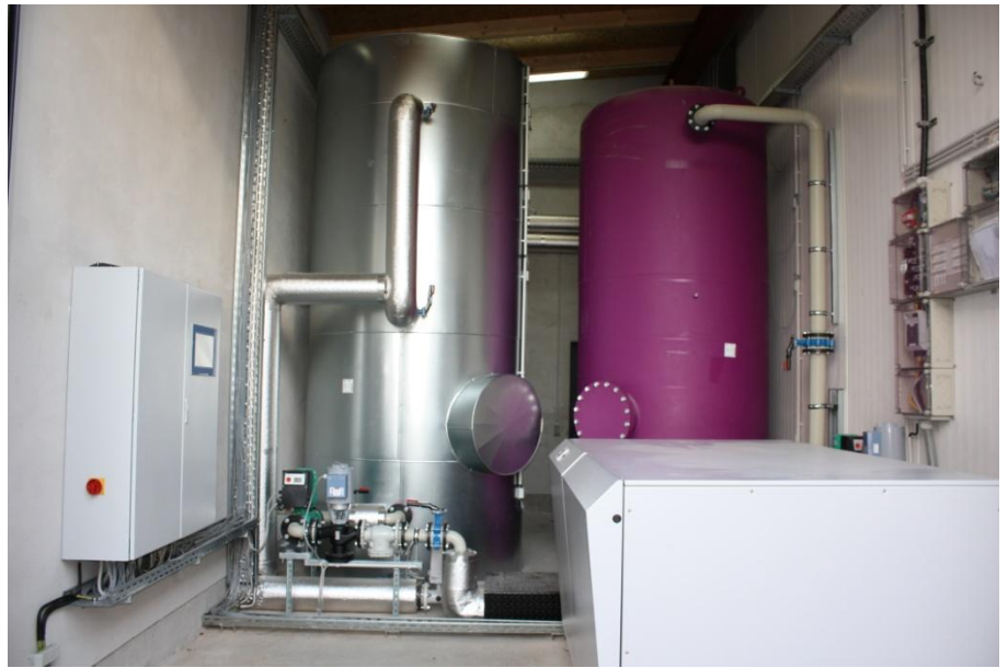
Neues Wärmerückgewinnungs-System bei Fa. Hennecke
